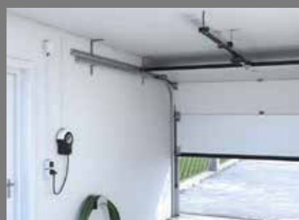
Řídicí jednotka v prostoru garáže
